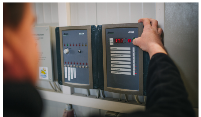
Abbildung 69: Die Technik unterstützt bei der täglichen Kontrolle und erfassen der Leistungsparameter (© AMA)
