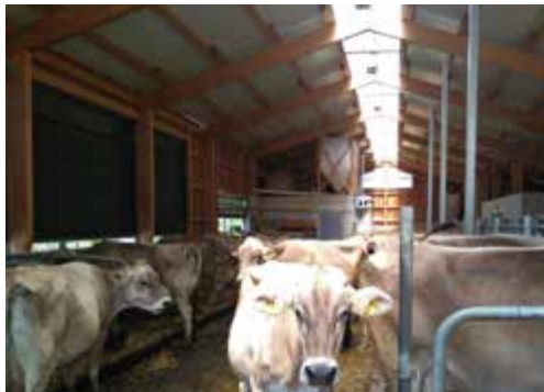
Firstentlüftung im Hallenstall
