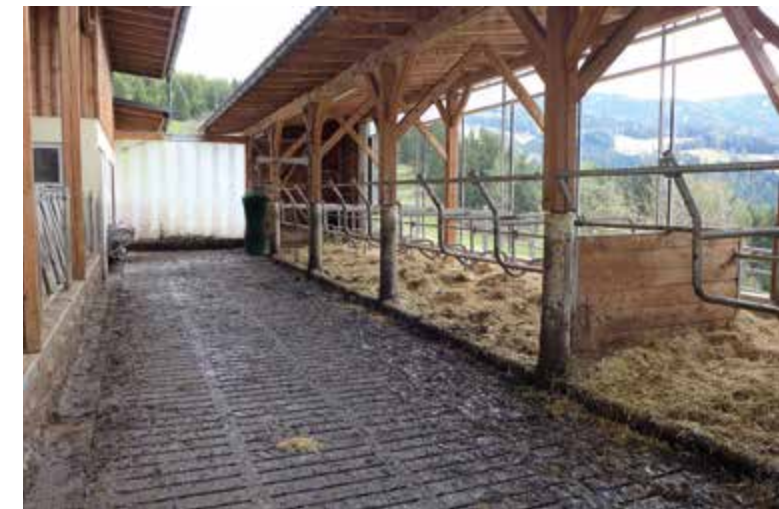
Laufgang mit darunter liegender Güllegrube
