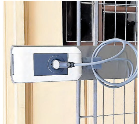
Wallbox zur Aufladung der eigenen E-Fahrzeuge.
